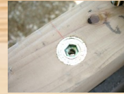
土台に埋め込まれたスクリューワッシャー
